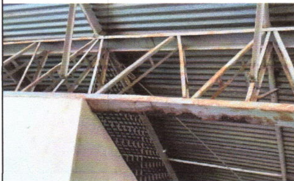
Vista da cobertura danificada
