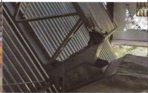
Vista da cobertura danificada
