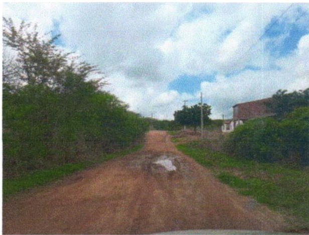
Vista de alguns dos problemas de drenagem
